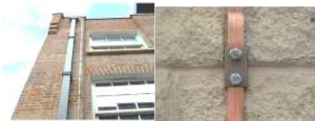
شکل (۶-۲) یک نوع سیم میله برق‌گیر در خارج از ساختمان
